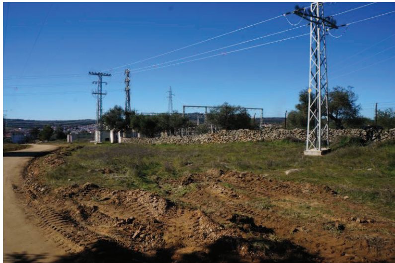
Vista final del trazado aéreo, subestación.
